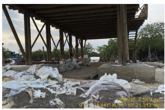
Fotografía No. 3 Relleno sacos de arena – Pilotes y zapatas en concreto. Vista frontal. Fuente: Informe de campo, PNNCRSB, 2025.
