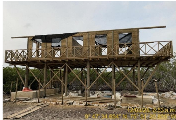
Fotografía No. 2 Estructura en proceso de construcción. Vista lateral. Fuente: Informe de campo, PNNCRSB, 2025.
