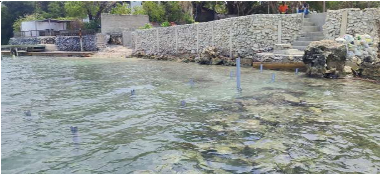
Imagen2: infraestructura encontrada el día 18 de abril del 2024
