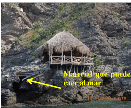
Figura 12 A. Kiosco construido en el supralitoral. Se observa plataforma en cemento bajo esta hay unos listones (en mal estado) de los cuales se desconoce el material los cuales se están desprendiendo.
