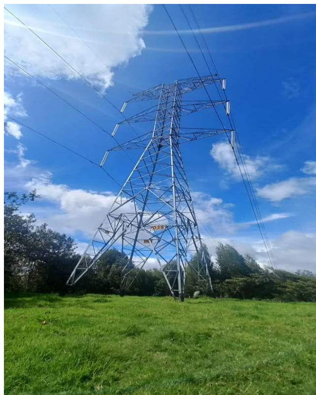
Figura 5: Torre de servidumbre eléctrica a cargo de la empresa de Grupo Energía Bogotá.
