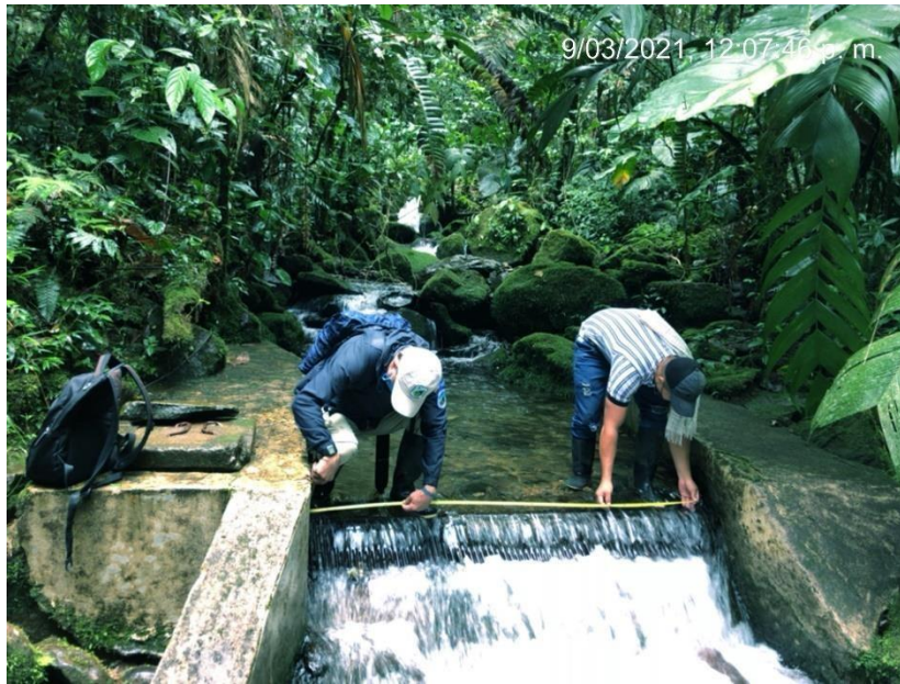
Foto 4. Bocatoma Las Agüitas, rejilla de fondo
